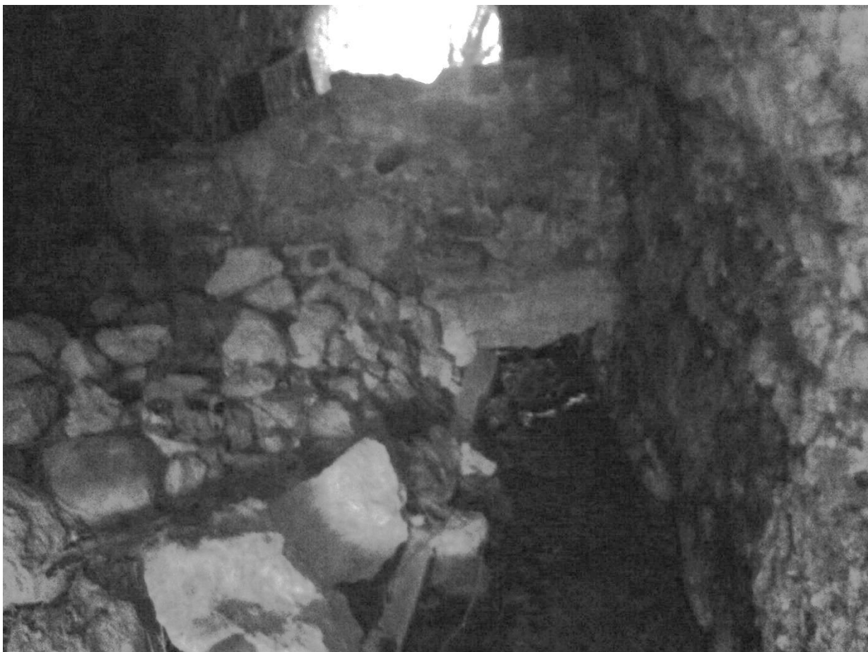
PHOTO 2 : MUR DANS LE DALOT
